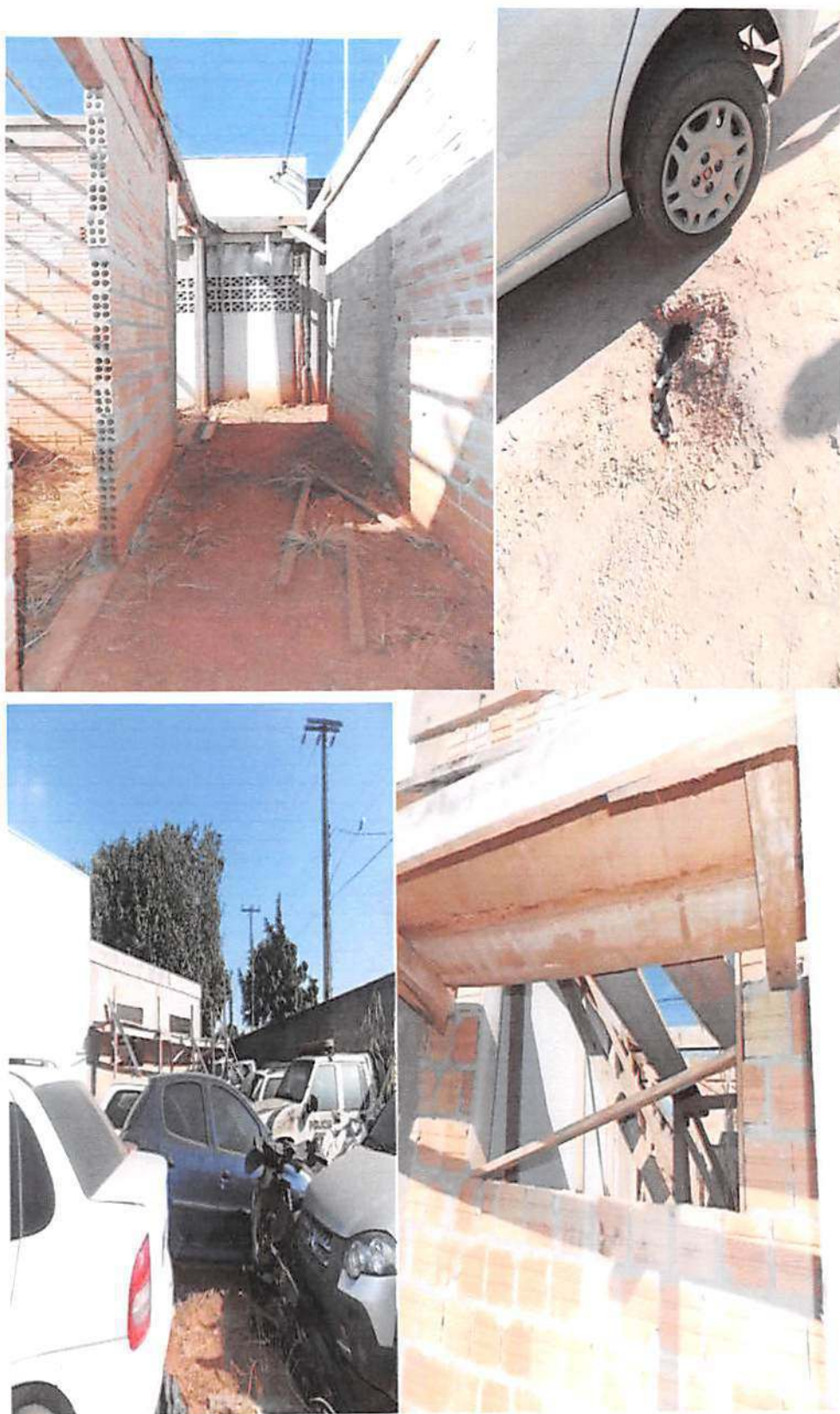
GARAGEM DE SERVICO COM FOSSA ABERTA AO LADO, ESTACIONAMENTO PARA VEÍCULOS APREENDIDOS , OBRA DE AMPLIAÇÃO PARALIZADA.
