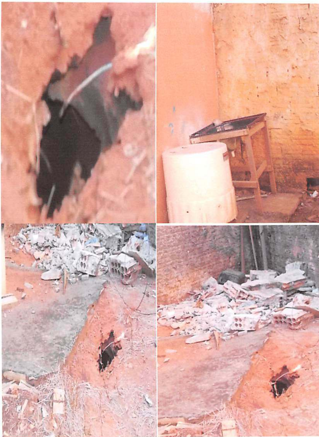
SUPOSTA LAVANDERIA , COM ESGOTO A CÉU ABERTO NO MESMO ESPAÇO FÍSICO.
