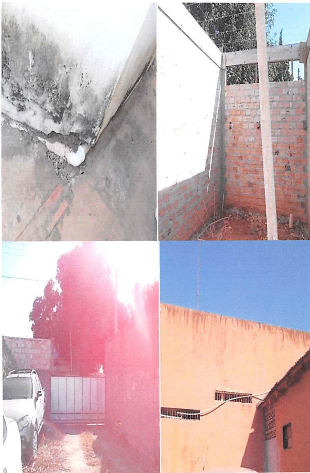
TUBULAÇÃO PRECÁRIA, PORTÃO BAIXO SEM SEGURANÇA, OBRA PARALIZADA.
