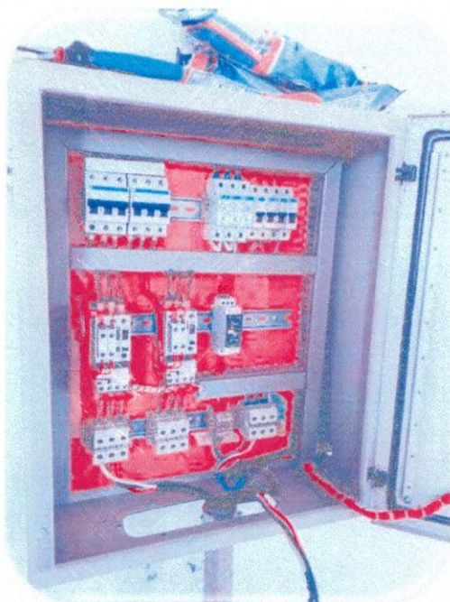
Figura 21 – Novo painel na ETE
