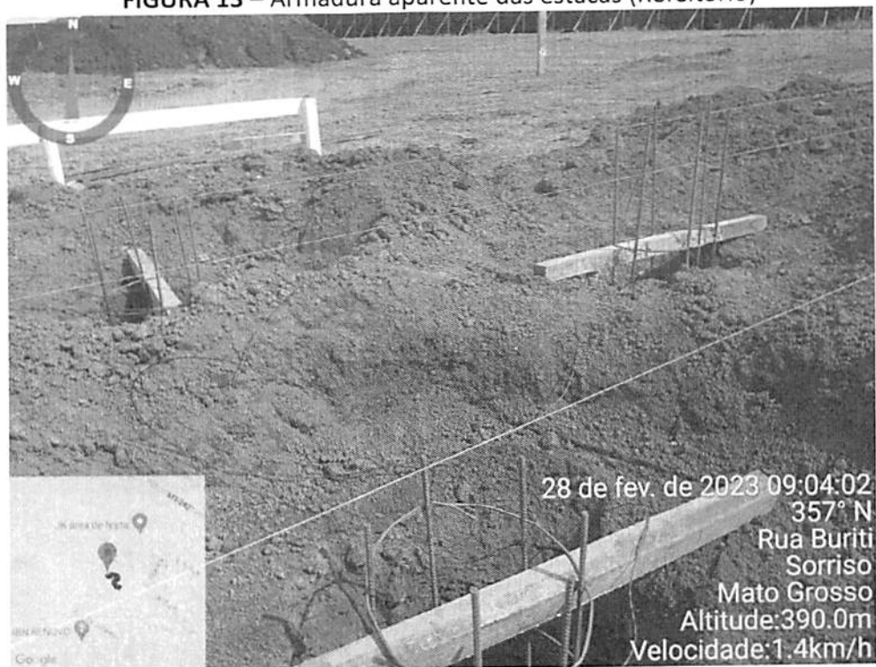
FIGURA 13 – Armadura aparente das estacas (Refeitório)
