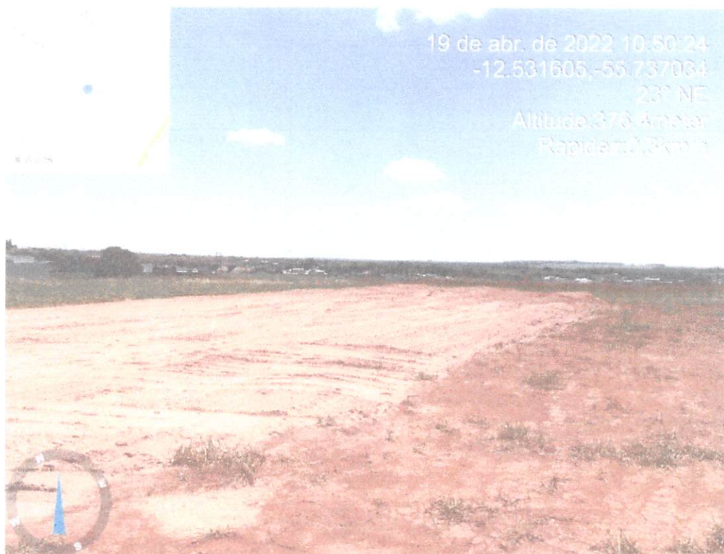
Foto 01: Somente foi feita a terraplanagem de forma incompleta.
