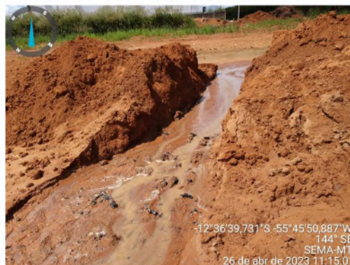
Foto 02. Água escorrendo para o barramento.
