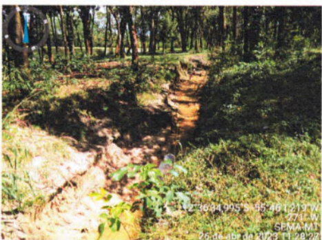
Foto 05. Água escorrendo para propriedade vizinha.
