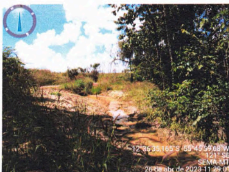
Foto 06. Água escorrendo para propriedade vizinha.
