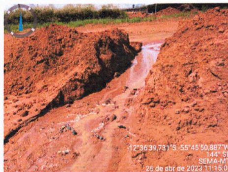
Foto 02. Água escorrendo para o barramento.
