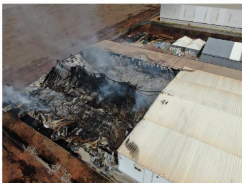
Foto 03. Depósito destruído pelo incêndio.
