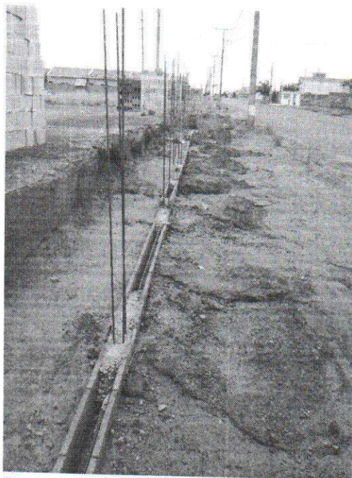
Figura 1 - Inserida no sistema SIMEC na vistoria 04
