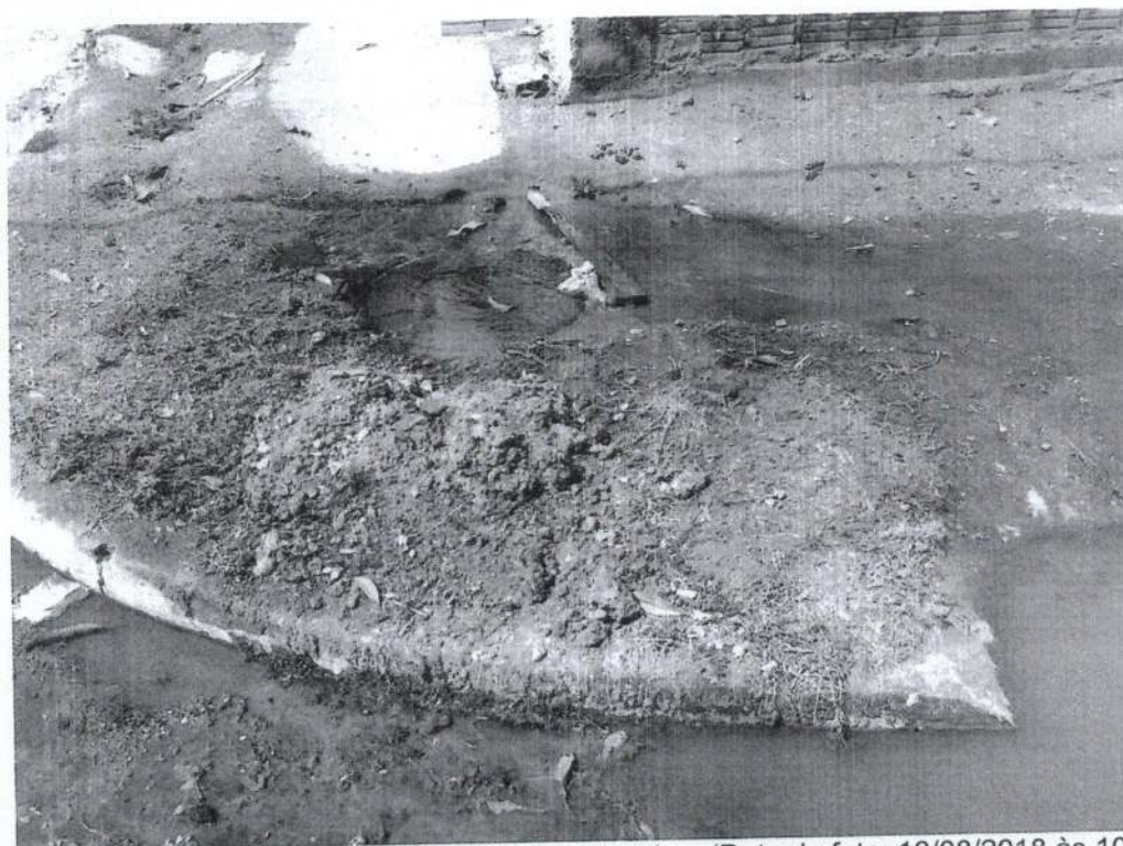
Foto 01: Poço de Visita onde o esgoto domestico transbordou. (Data da foto: 10/08/2018 às 10h42min)
