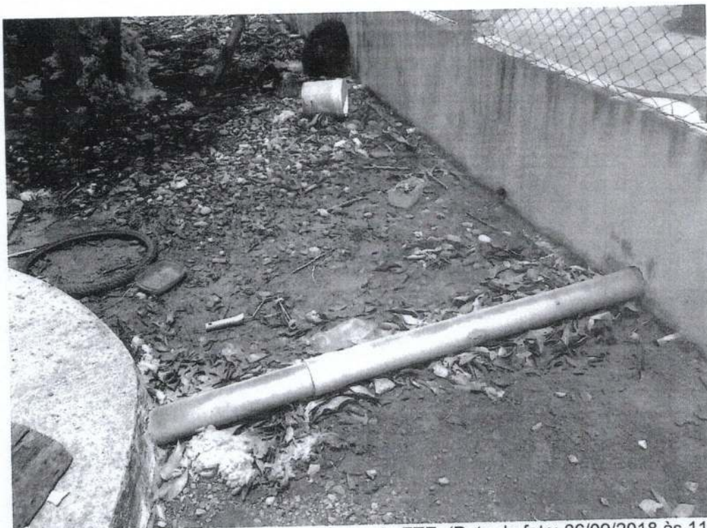
Foto 03: Efluente de esgoto empoeado no entorno da ETE. (Data da foto: 26/09/2018 às 11h49min)
