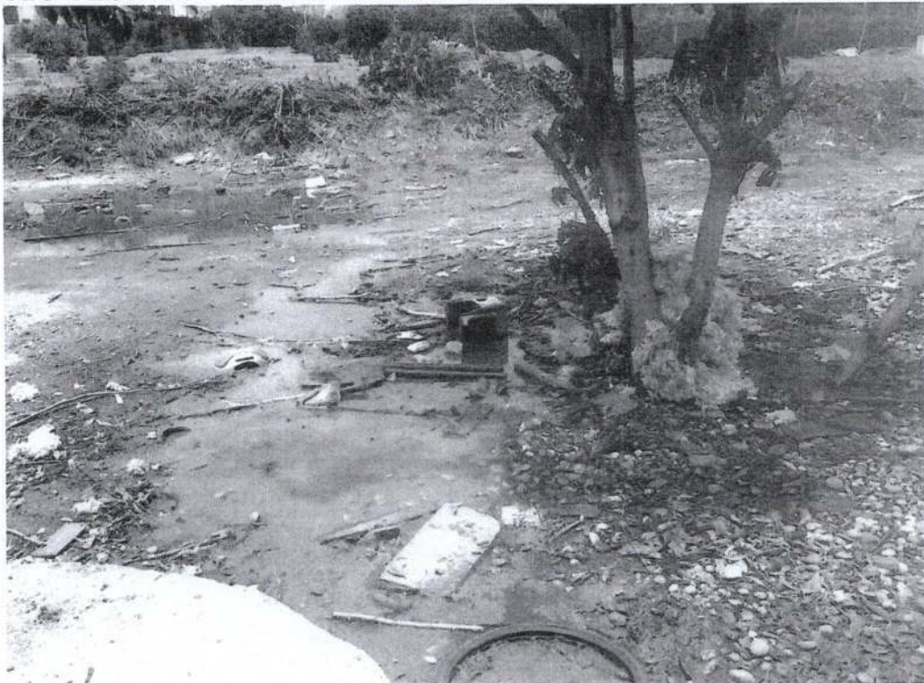
Foto 04: Efluente de esgoto empocado no entorno da ETE. (Data da foto: 26/09/2018 às 11h50min)
