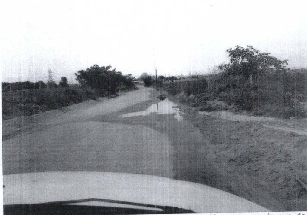
Foto 05: O efluente de esgoto domestico segue cerca de 200,00 metros na via que da acesso as propriedades rurais. (Data da foto: 10/08/2018 às 10h56min)
