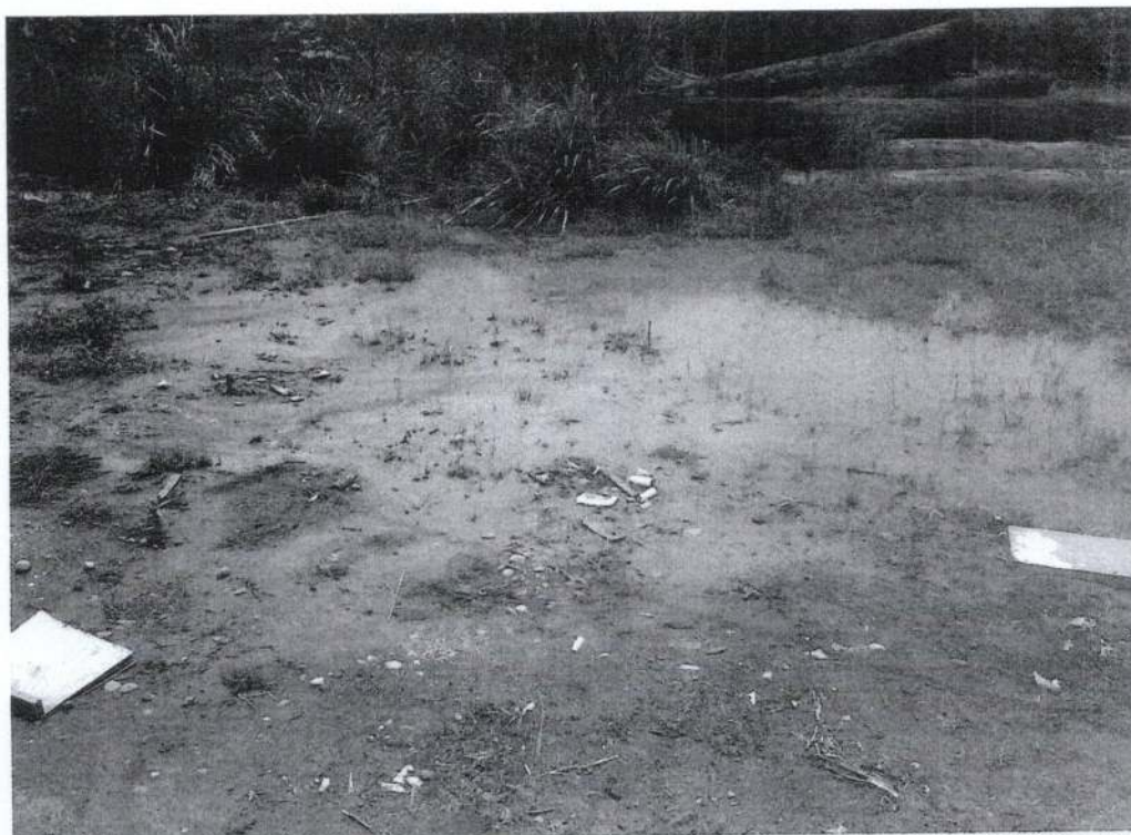
Foto 05: Efluente de esgoto empocado no entorno da ETE. (Data da foto: 26/09/2018 às 11h49min)
