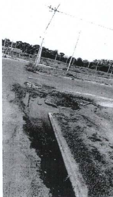
Foto 02 – Visão geral do extravasamento.
