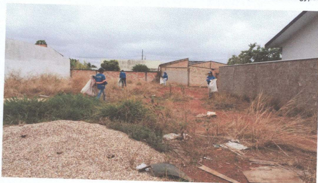
Limpeza do terreno baldio com mato alto.
